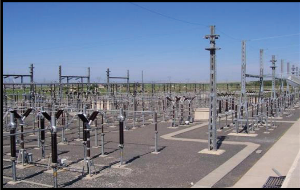
Resim 2.9 Bir şalt sahasının görünüşü
