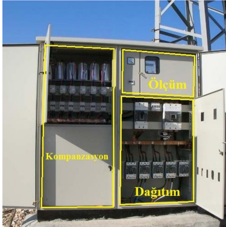
Bir benzin istasyonuna ait direk tipi trafonun AG ölçüm, dağıtım ve kompanzasyon panosu
