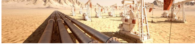
Şekil 7.1. Boru hattı tesisi [6].
