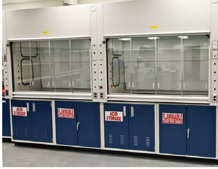
Görsel 2.46. Asitle çalışmak için çekerocek havalandırma sistemleri
